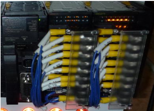
Gambar 4.21 Pengujian masukan PLC pada status LED PLC
